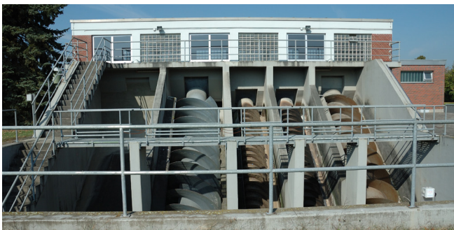
Hebewerk der Kläranlage Limburg/Staffel
