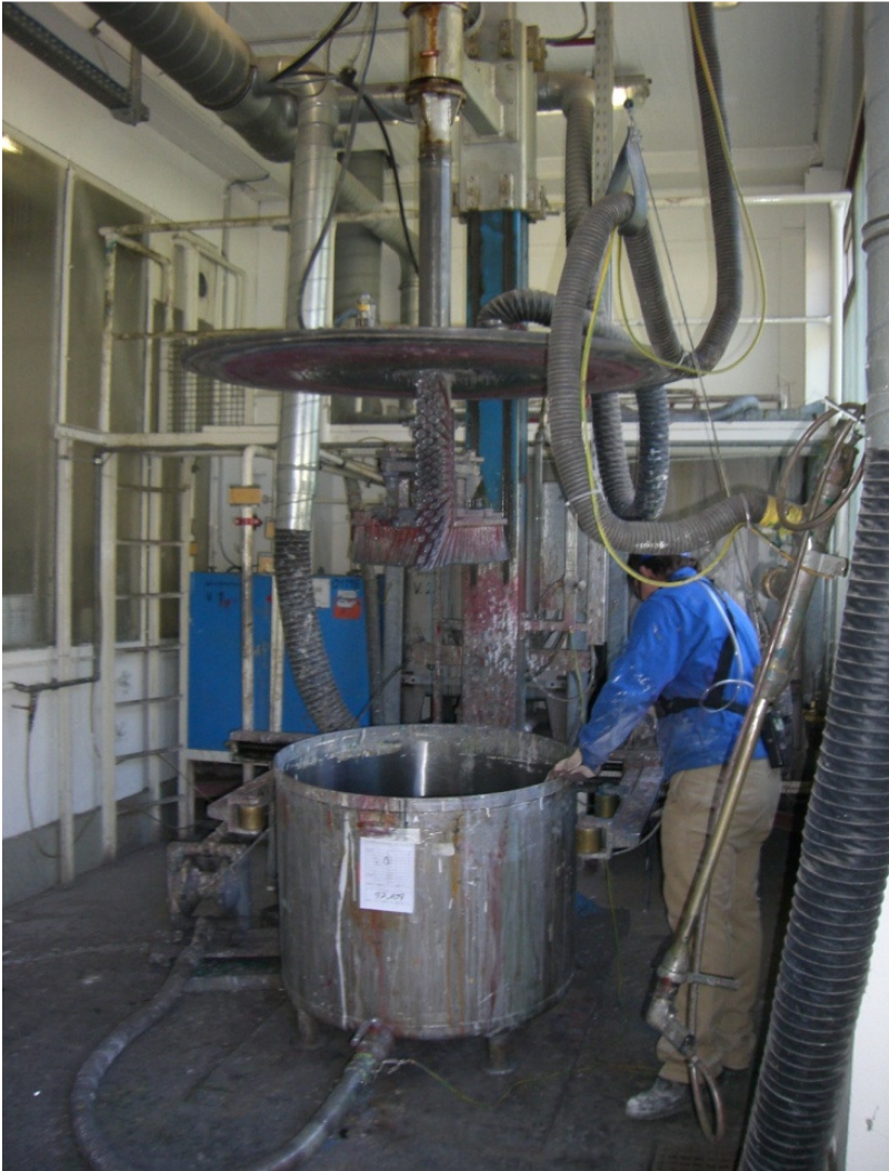
ABBILDUNG 12: AUTOMATISCHE BEHÄLTERREINIGUNG MIT BÜRSTENSYSTEM IM SEPARATEN RAUM
