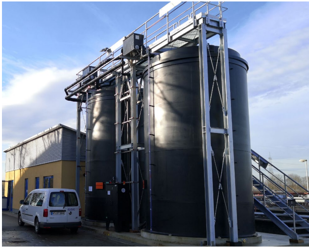
Abbildung 5: Lagertanks und Betriebsgebäude der neuen Fällmittelstation der Kläranlage Gießen © MWB
