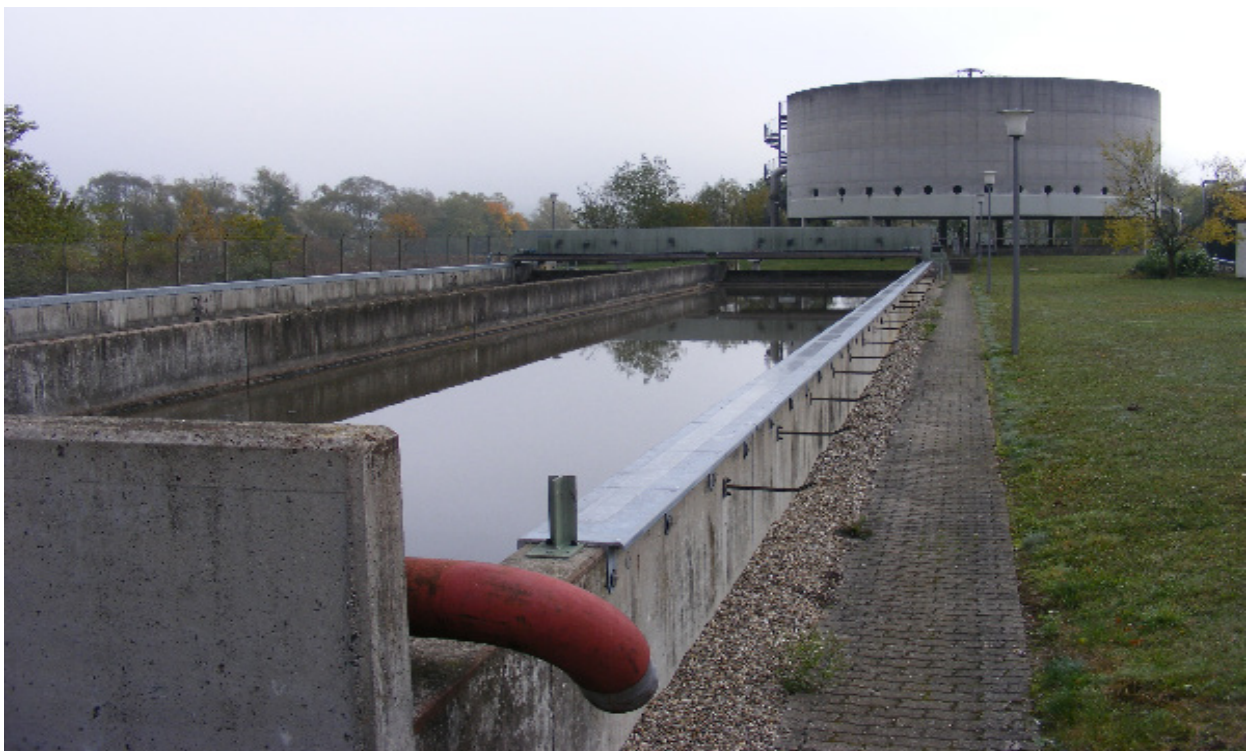
Abbildung 9: Tropfkörper mit untenliegendem Belebungsbecken im Hintergrund auf der Kläranlage Lauterbach.
