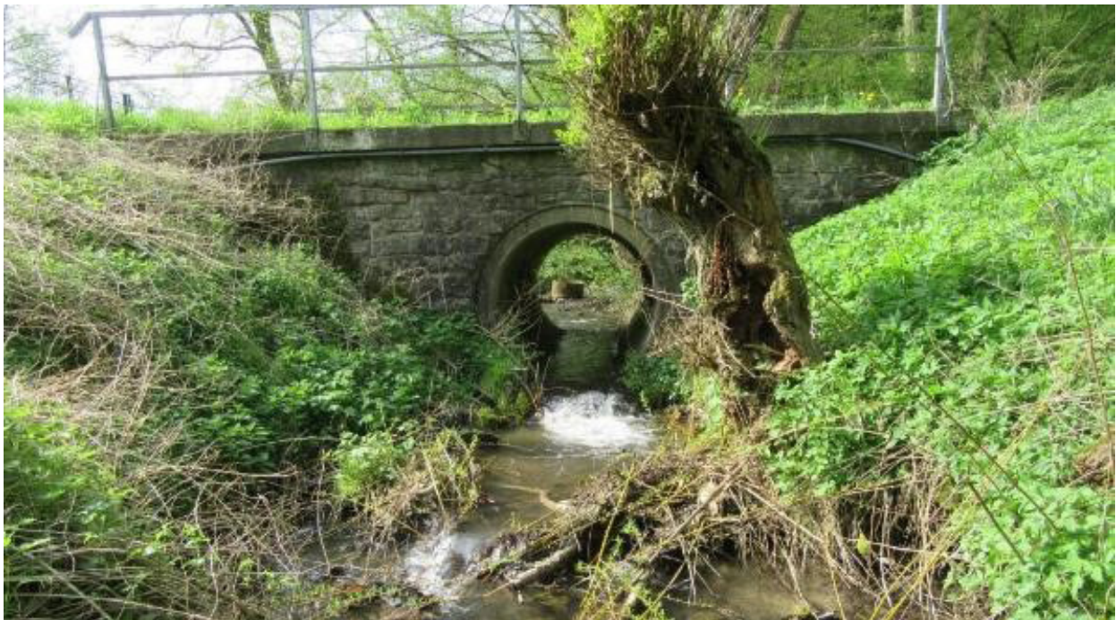
Abbildung 5: Unpassierbarer Rohrdurchlass am Tiefenbach bei Braunfels.
